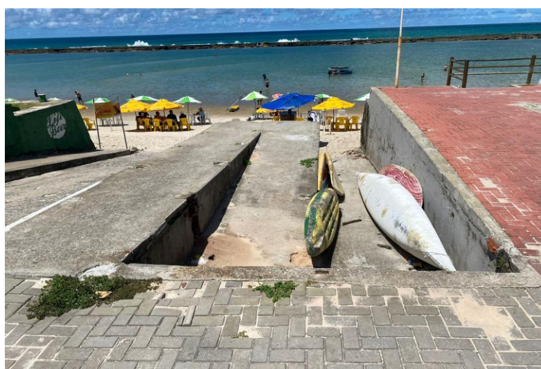
Figura 24: Rampa de acessibilidade no Recanto dos Caetés.
